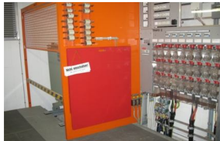
Innenleben einer Trafostation
