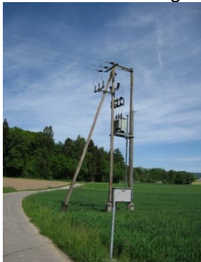
Stangentrafo in der Weid
